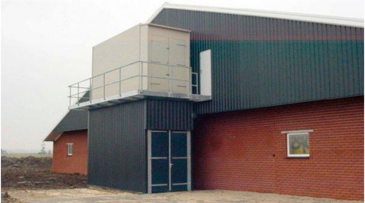
Figura 2: Depurador biológico de aire de la granja
